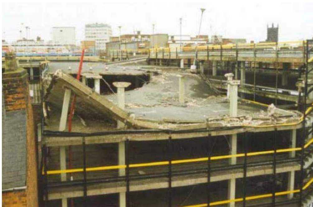
FIGURA 1 – COLAPSO ÚLTIMO PAVIMENTO EDIFÍCIO-GARAGEM EM WOLVERHAMPTON, INGLATERRA FONTE: WOOD (2003)
